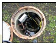
Entnahmeschacht mit Förderpumpe
