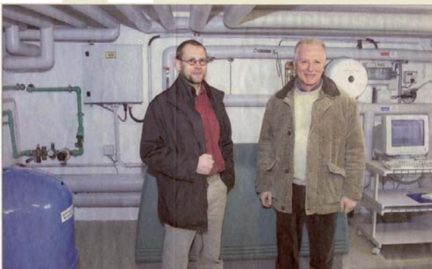
Haben Grund zum Optimismus: Lutz Gerstenberger und Harald Roth (v.) präsentieren heute bei der Wasser und Tiefbau GmbH Kamenz in Jesau nicht nur interessante, sondern auch funktionierende Idee. Die Firma wird seit Dezember komplett aus der Abwärme eines Abwassers-Hauptsammlers beheizt. Foto: nur
