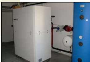
Wärmepumpe u. Pufferspeicher
