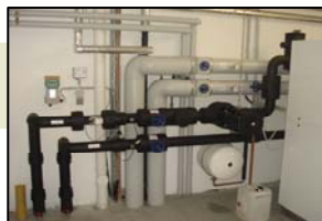
Vor- und Rücklauf Heizung
