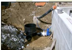
Talschacht mit Absperschieber
