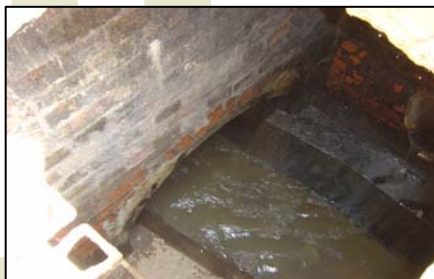
Abwasserkanal (Mischwasser) DN 1000
